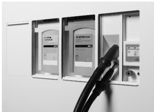
Abbildung 63 - Ansaugschläuche bereit für die Desinfektion des Ansaugsystems
