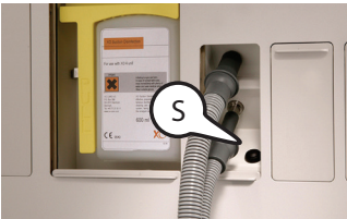
Afzuigslangen bevestigd aan nippels ter desinfectie
